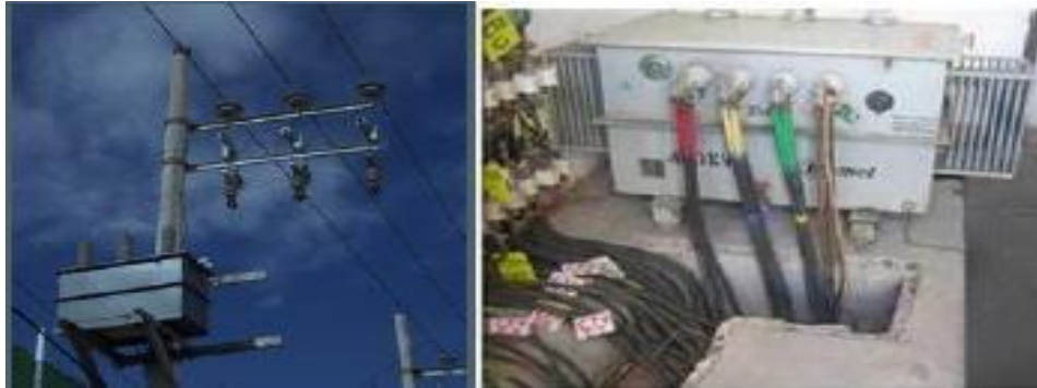
Figura 4: Transformadores: aéreo y de cámara Fuente: (Montajes, 2017)
