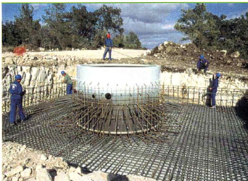
Fig. No. 3.12 Fundición de la base de la torre de un aerogenerador
