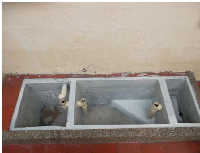
Ilustración 18 Trampa de grasa hecha de cemento
