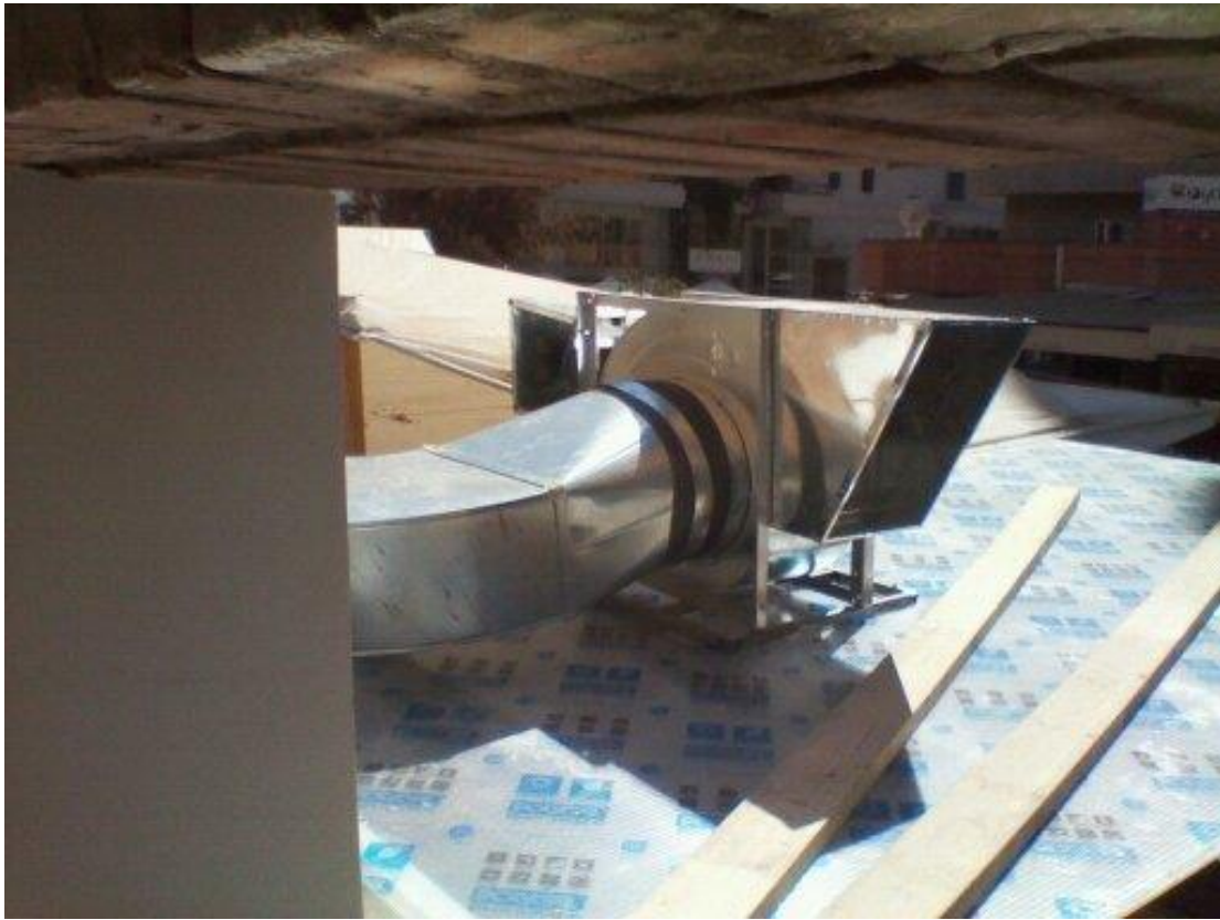
Ilustración 17 Ducto de inyección de aire...
