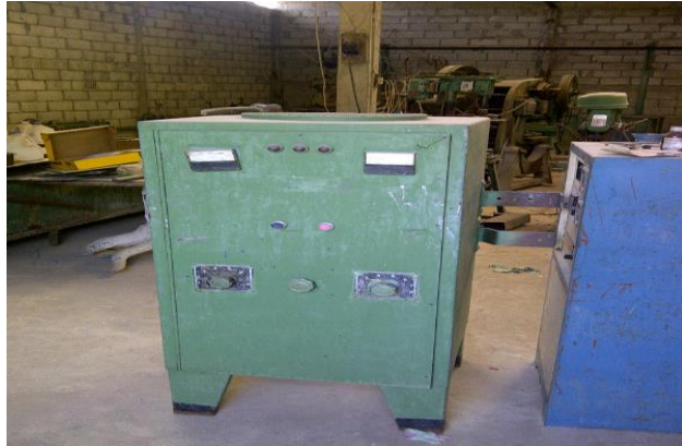
Ilustración 19 Rectificadora de corriente para baños de níquel y cromo
